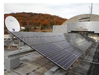
大和庁舎屋上の太陽光パネル
